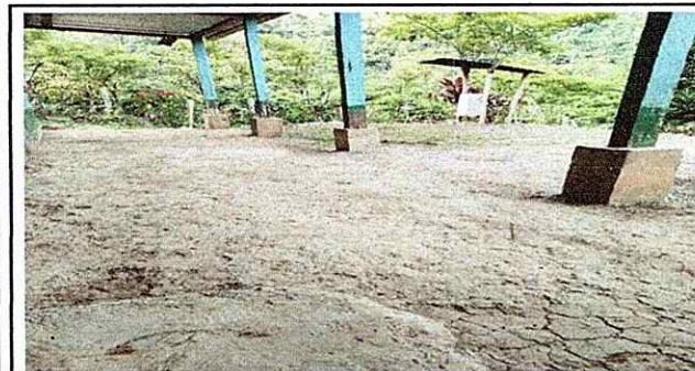
Foto 5: En esta fotografía se puede observar la parte del corredor del Establecimiento, en la cual el piso granito quedo aplazado.
