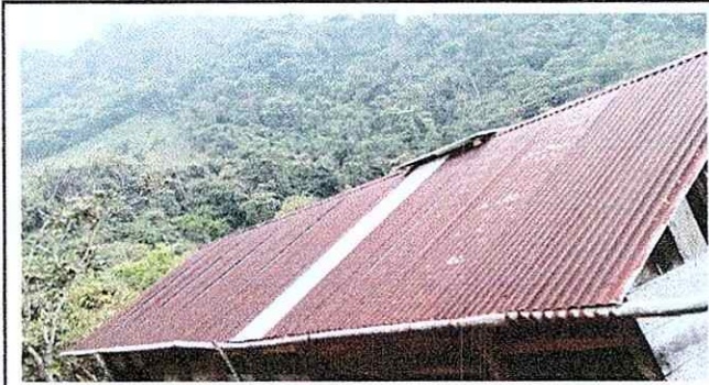
Foto 1: Se puede observar la parte de atrás del Centro Educativo y se verifica el oxido en las laminas.
