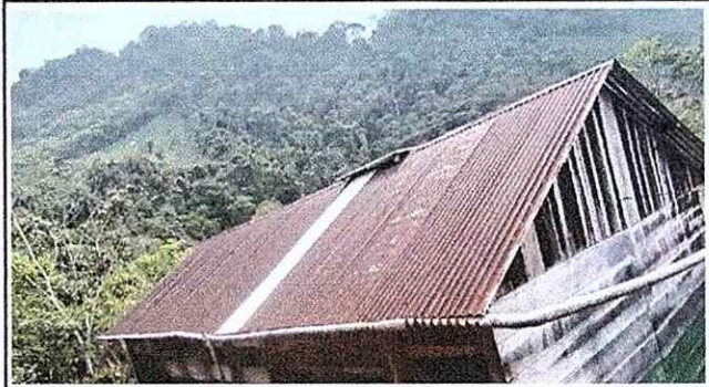
Foto 2: Se puede observar la parte de atrás del Centro Educativo y se verifica el oxido y el deterioro de las laminas.
