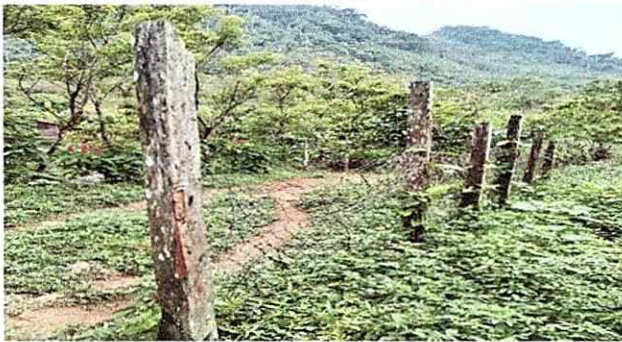
Foto 3: En esta fotografía se puede observar el cerco perimetral de la Escuela, en la cual la malla esta en malas condiciones.
