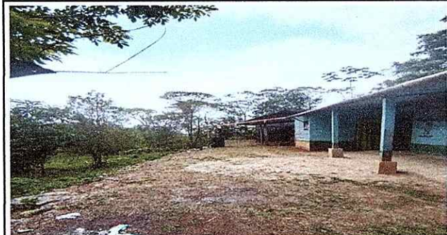
Foto 4: En esta fotografía se puede observar la parte de enfrente del Establecimiento, en la cual la losa de patio esta inconclusa y el deterioro de la misma.
