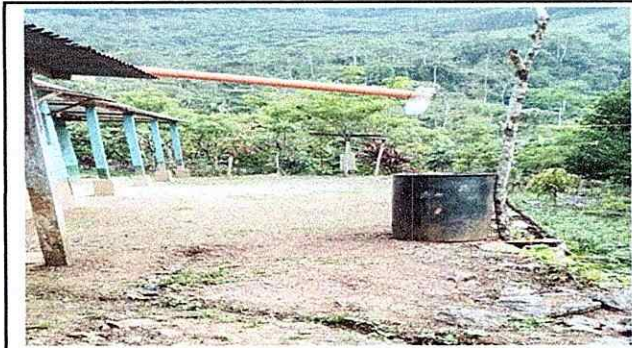
Foto1: En esta fotografía se observa el Deposito del agua del Establecimiento y el deterioro de la misma.
