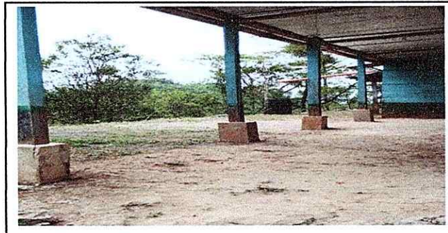
Foto 6: En esta fotografía se puede observar la parte del corredor del Establecimiento, en la cual el piso granito quedo aplazado.
