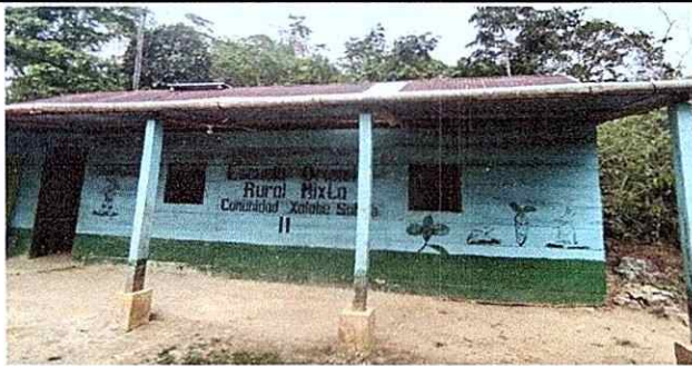
Foto 5: En esta fotografía se puede observar la parte de enfrente y se verifica el deterioro de la pintura del Establecimiento Educativo.
