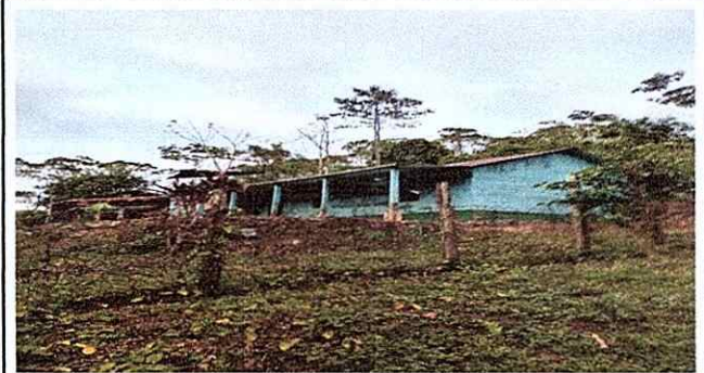
Foto 2: En esta fotografía se puede observar la parte izquierda de la entrada de la Escuela, en la cual el cerco perimetral esta en desnivel y el deterioro de este.
