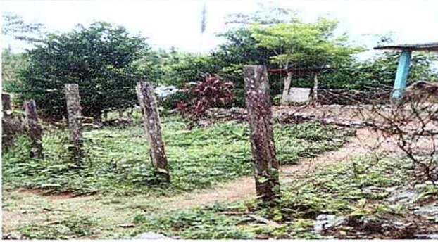
Foto 1: En esta fotografía se puede observar la parte de la entrada de la Escuela, en la cual el cerco perimetral esta en desnivel y el deterioro de este.
