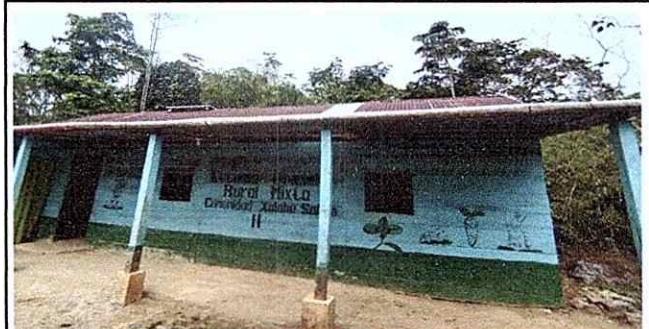
Foto 6: En esta fotografía se puede observar la parte de enfrente y se verifica el deterioro de la pintura del Establecimiento Educativo.
